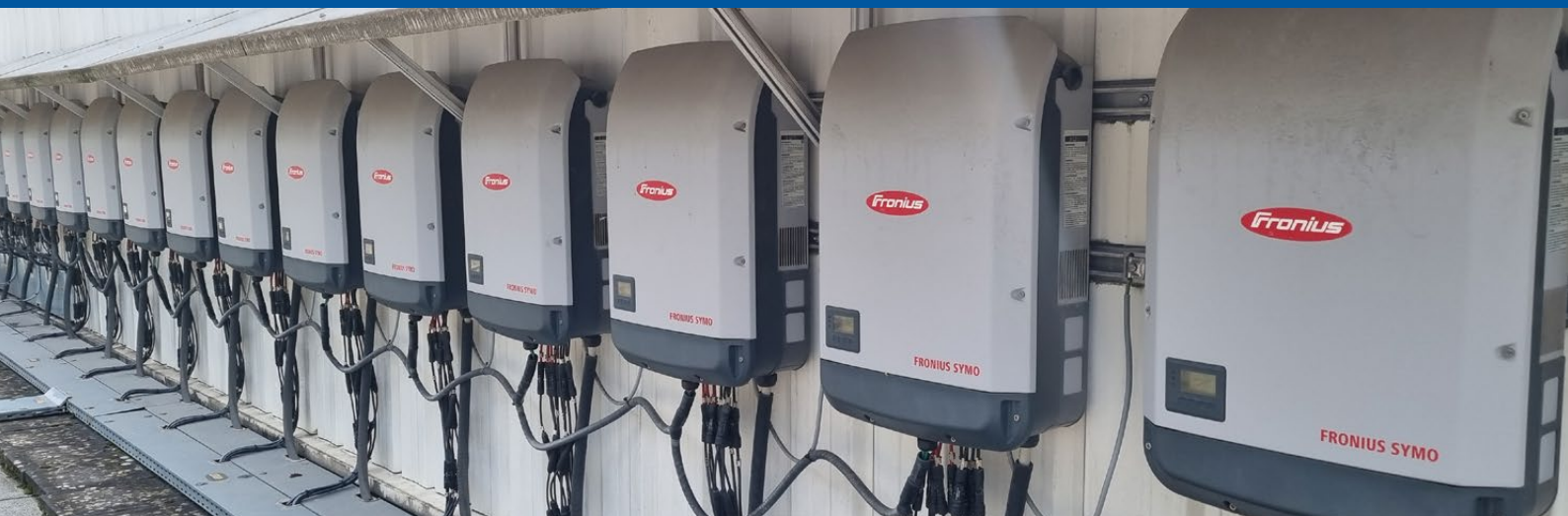
Zukauf 2023: PV-Anlage Villeneuve am Genfersee. Mit 522 kWp die drittgrösste Anlage der Alteno Solar AG
