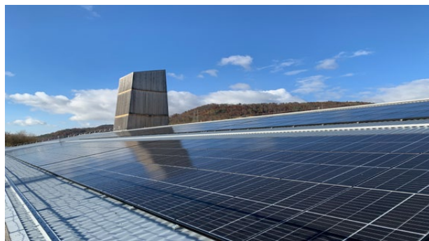
Eine Anlage des Kantons Basel-Landschaft aus dem Portfolio von PV-Care, der Werkhof in Sissach.
